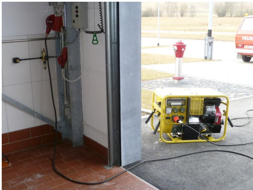
Abbildung 3 Einspeisung mit einem tragbaren Stromerzeuger über die Einspeisestelle in die elektrische Anlage des Feuerwehrhauses in Münchhausen [4]
